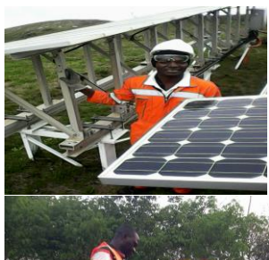
SYSTEME PV POUR PYLON DE TELECOMMUNICATION
